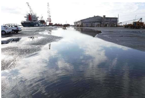
大浜ふ頭の舗装沈下状況
