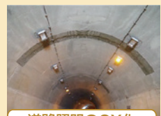
道路照明のGX化 (LED化)
