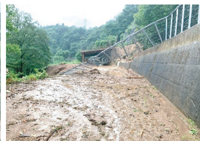
一般国道344号 法面崩壊状況
